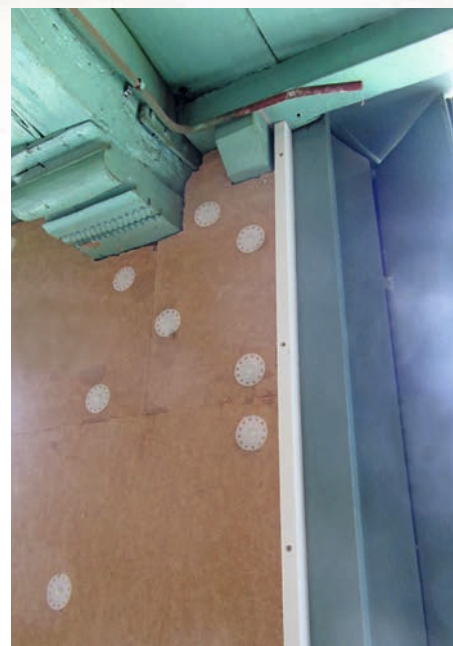
Houtvezelplaten rond een van de balkkoppen
