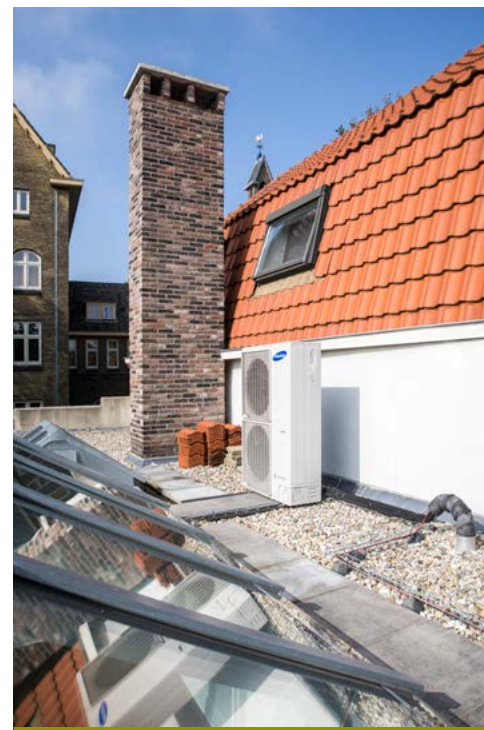
Warmtepomp op het platte dak, vanaf de weg niet te zien
